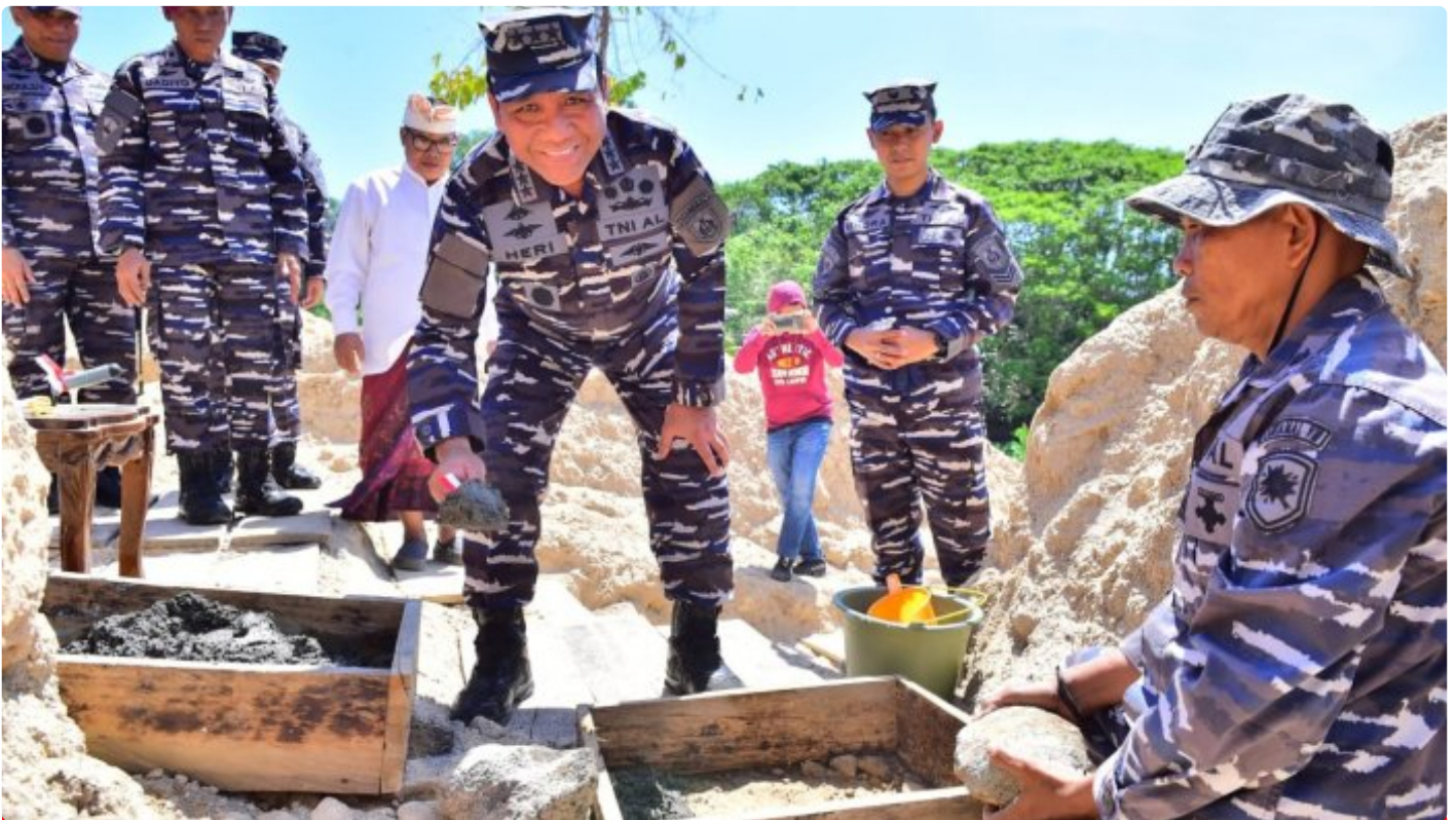
Peletakan baru pertama pembangunan Pura Cakra Santhi Buana oleh Wakasal Laksamana Madya TNI Ahmadi Heri Purwono
